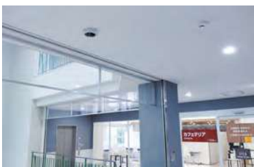
2階 エレベーター前
